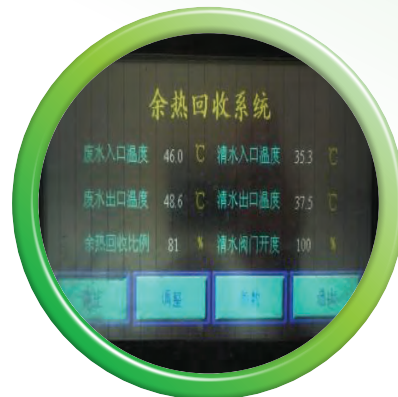
餘熱回收系統現場監控面板
