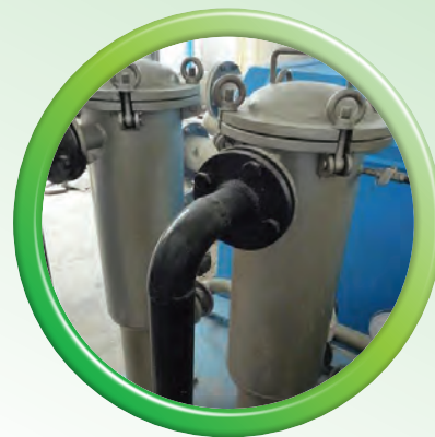
熱交換器前的過濾器
